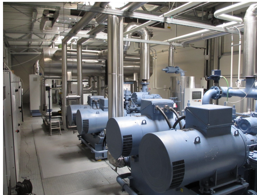
Figur 3.7 – Varmepumpeanlægget i energicentralen. Kilde: Høje Taastrup Fjernvarme A.m.b.a.
