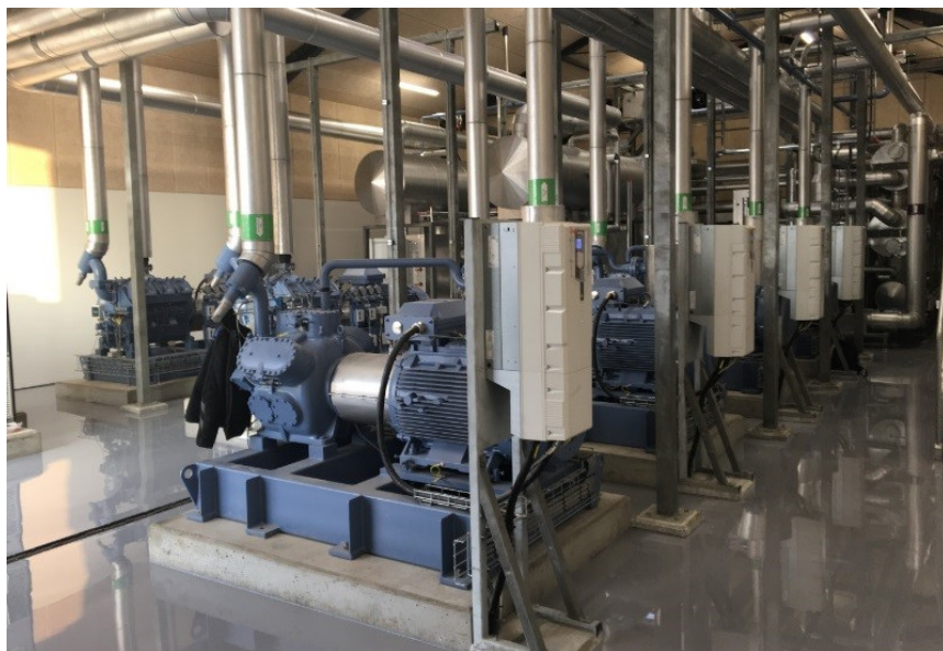
Figur 6.8 – Grundvandsvarmepumpe i Broager.
