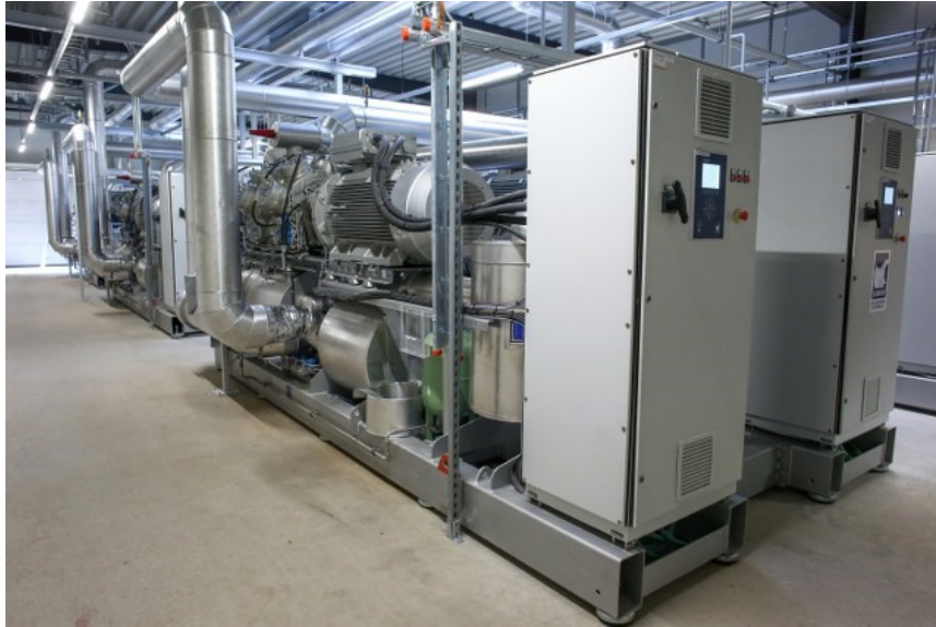
Figur 5.8 – Varmepumpeanlægget i Kalundborg, Enheden forrest på billedet med de to elskabe, udgør den ene halvdel af et “varmepumpesæt”. Det samlede anlæg består af i alt seks lignende enheder.
