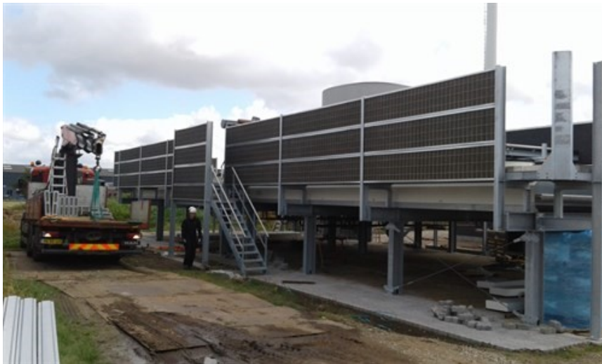
Figur 8.4 – Billede af støjskærm ved udeluftkølerne.
