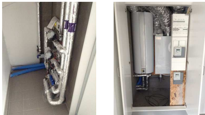
Figur 10 Fjernvarme- og brugsvandsinstallationen i dobbelthusene
